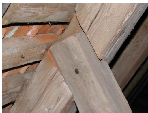
Obr. 8 Záměrné změny – nevhodně modifikovaný spoj
