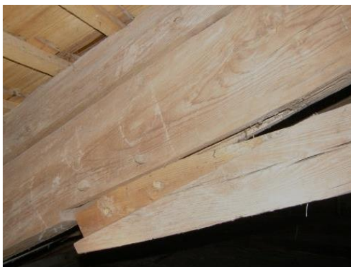
Obr. 5 Částečně rozpojený spoj
